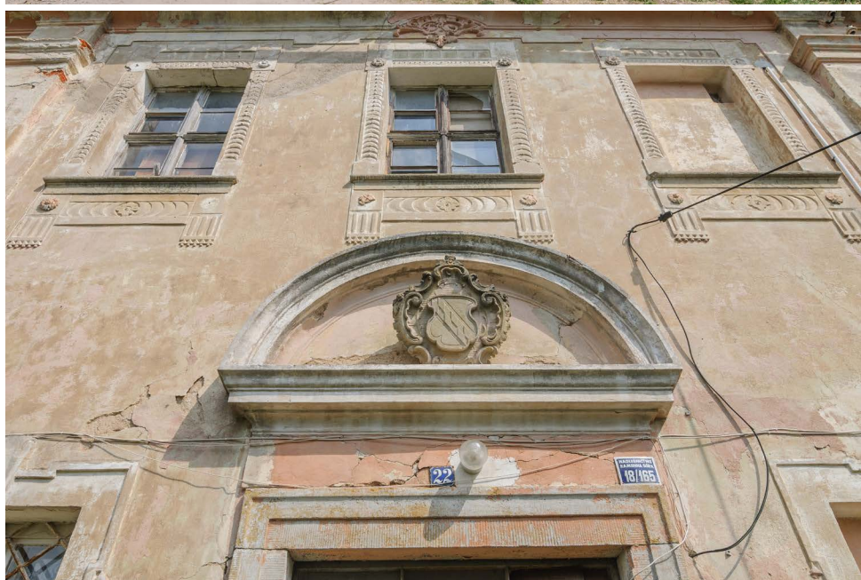
Fot. 26–28. Zespół dworu opatów w Krzeszowie i kościoła św. Krzysztofa położony w Ulanowicach (Ullersdorf), dziś część Lubawki. Dwór wraz z kościołem został wzniesiony z inicjatywy opata Dominicusa Geyera, w niewielkim stopniu przebudowany pod koniec XVIII w. Niegdyś lokalne centrum pielgrzymkowe kultu Czternastu Wspomożycieli, po kasacie klasztoru zaniedbane. Z bogatego wystroju rzeźbiarskiego (statuty Wspomożycieli na drodze wiodącej do kościoła) i malarskiego (portrety opatów w dworze) dziś pozostało niewiele. Warto zwrócić uwagę na przejście na wysokości pierwszego piętra dające mieszkańcom dworu bezpośredni dostęp do kościoła
